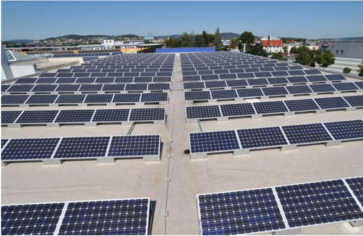
s:box® auf Foliendach
