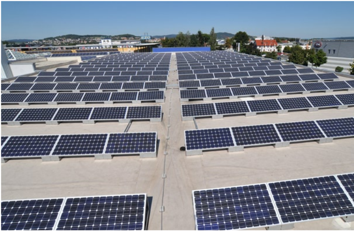
s:box® auf Foliendach
